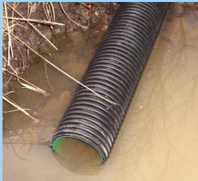
Purkuputken ei tulisi olla vedessä
