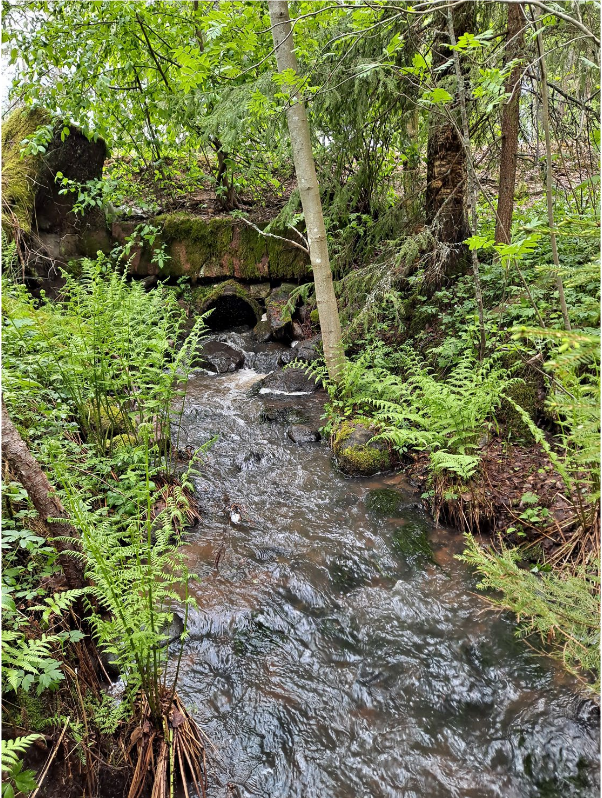
Kuva 9. Lammenjärven puron vaelluseste on puuroon rakennetun lammen settipato. Settipadon jälkeen vesi virtaa tierumpuun. Pato estää kokonaan kalojen vaelluksen.
